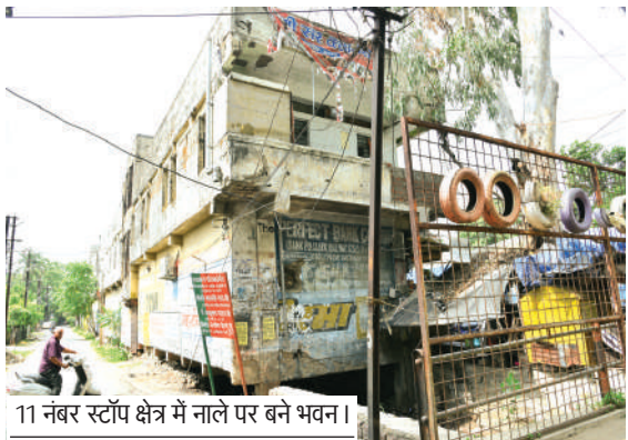
11 नंबर स्टॉप क्षेत्र में नाले पर बने भवन ।
